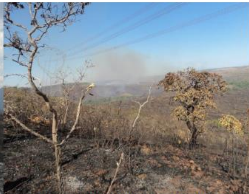
Figura 39 – Vão nº 565 atingido pela queimada dia 10/09/2014
